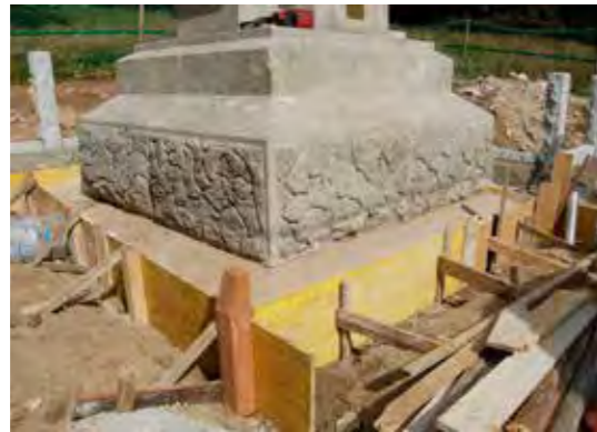
495 Particolare del basamento dell'obelisco prima dei lavori. Foto di T. Vicentini
