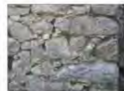
Tracce di dilavamento
