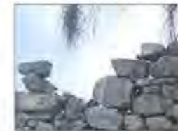
Elementi lapidei totalmente disgregati ed enucleati
