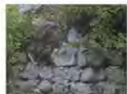
Limitata perdita di connessione delle pietre legata alla presenza di vegetazione
