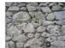
Elementi lapidei parzialmente enucleati in profondità (superiore alla metà del concio)
